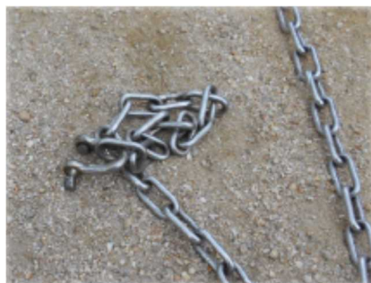
吊り金具破損状況
