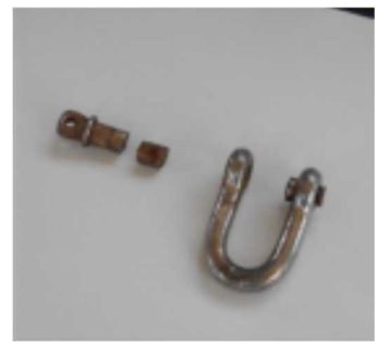
吊り金具破損部詳細
